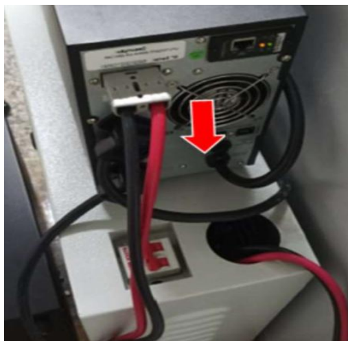
Figura 5: Cabo de alimentação do nobreak.
