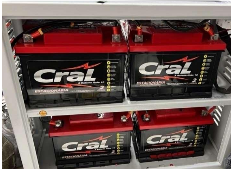
Figura 6: Baterias que compõe o banco de baterias.
