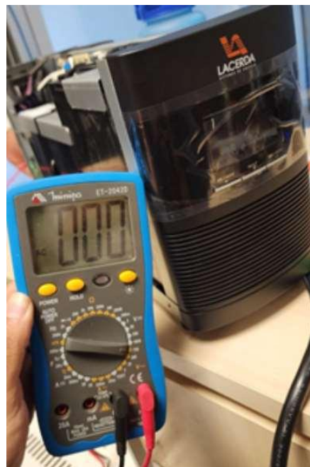
Figura 2: Medição realizada na tomada de saída do equipamento, com o nobreak completamente desligado e desplugado da tomada de energia
