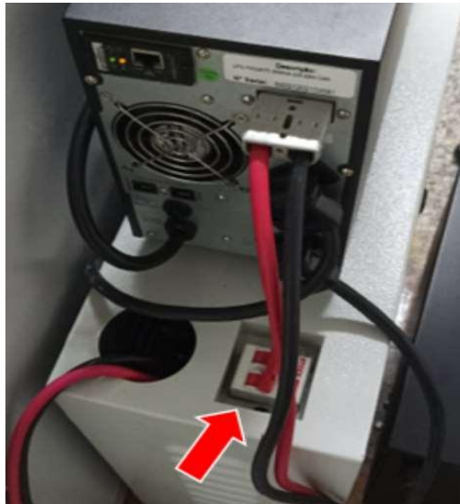
Figura 3: Disjuntor localizado no banco de baterias.
