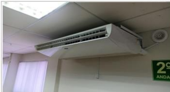
FOTO 115 - Evaporadora piso-teto 48 K - Carrier.
