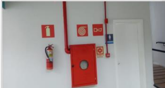
FOTO 51 - Abrigo metálico e placas de sinalização.
