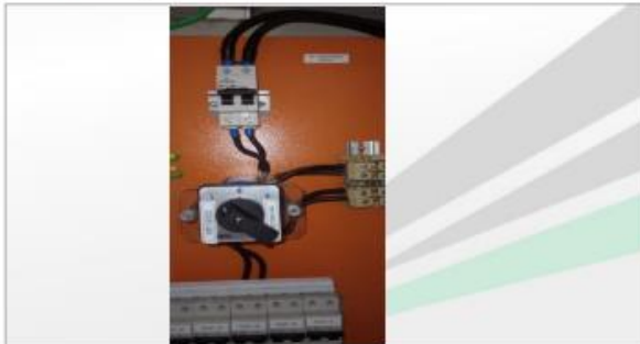
FOTO 63 - Quadro de automação nobreak 12000VA.
