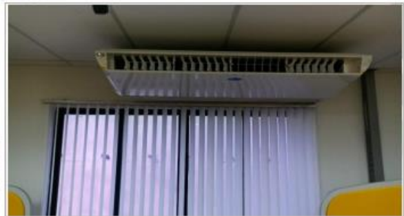
FOTO 116 - Evaporadora piso-teto 48 K - Carrier.
