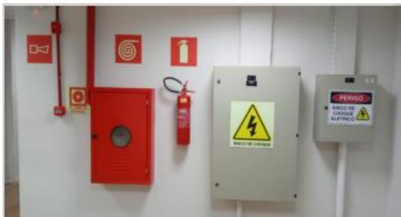
FOTO 57 - Abrigo metálico e quadro de energia 1º Pav.
