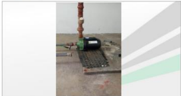
FOTO 28 - Bomba de recalque reservatórios - Prédio 01.
