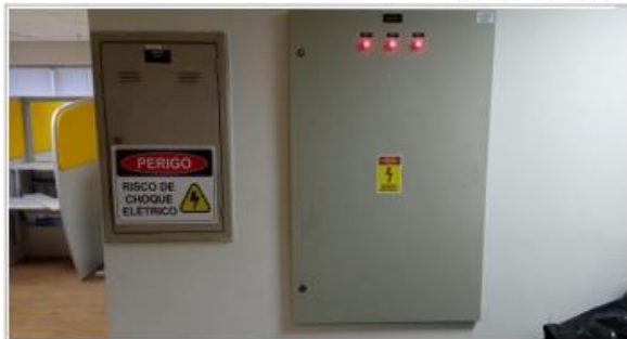
FOTO 55 - Quadro de rejeição de carga térreo.
