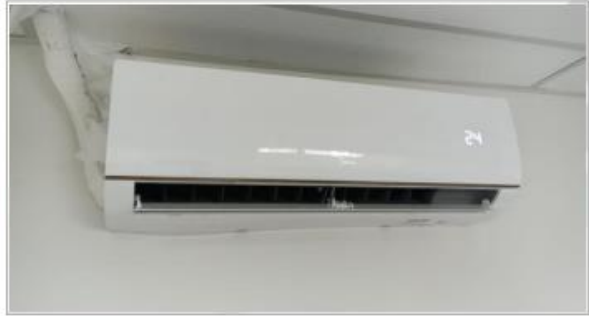
FOTO 112 - Evaporadora de 12K.
