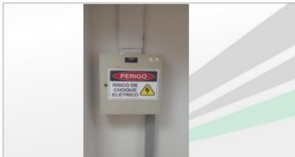
FOTO 33 - Quadro área técnica térreo - Mezanino.
