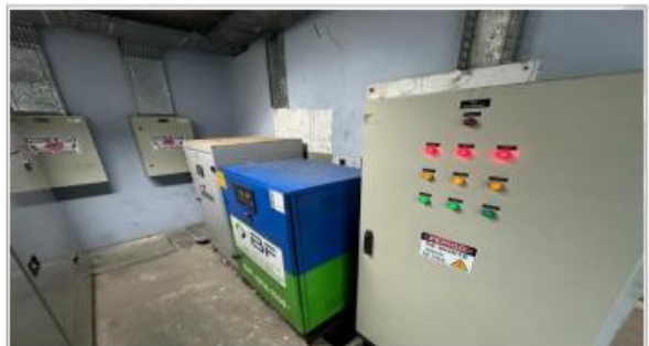
FOTO 72 - QTA gerador 220KVA e quadro de rejeição.
