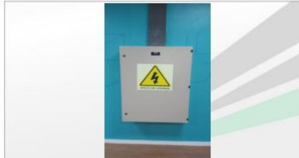
FOTO 52 - Quadro 2º Pav.
