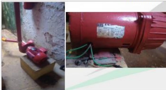
FOTO 49 - Vista complementar da bomba do sistema de PCI.
