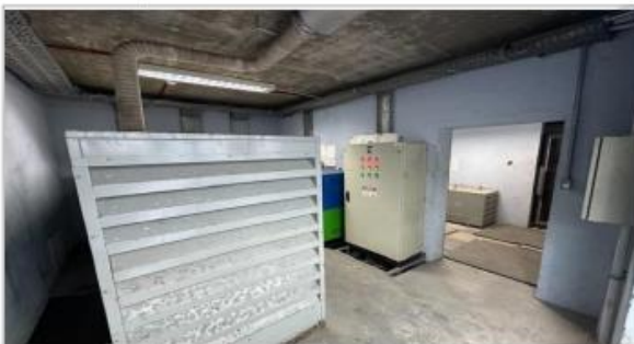
FOTO 71 - Sala do gerador de 220KVA.
