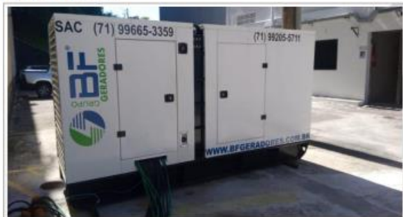
FOTO 56 - Gerador de 450 KVA - Rede estabilizada.
