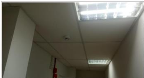
FOTO 60 - Dispositivo do sistema de detecção.
