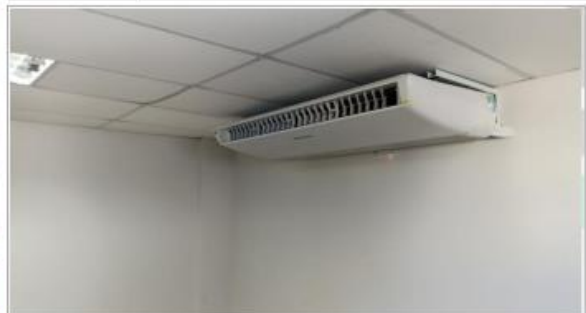
FOTO 120 - Evaporadora piso-teto 48 K - Carrier.
