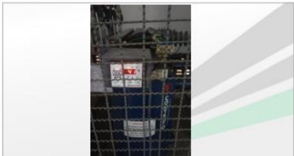
FOTO 66 - Relé de proteção dos transformadores.
