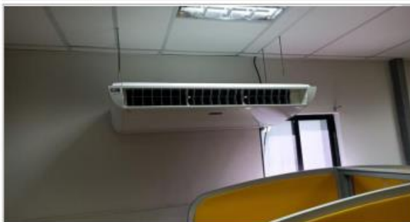
FOTO 119 - Evaporadora piso-teto 36 K - Carrier.
