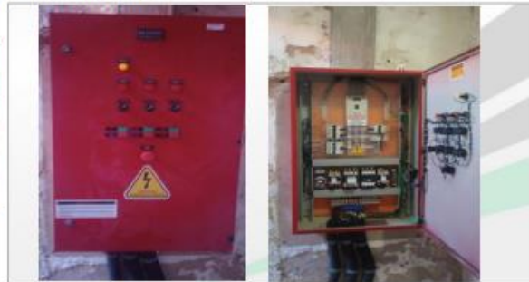
FOTO 50 - Novo quadro de automação das bombas.
