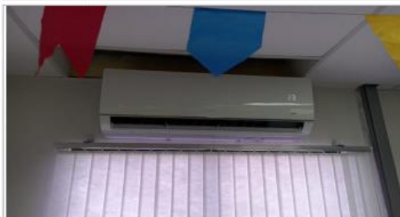
FOTO 117 - Evaporadora HW de 12K - Springer.
