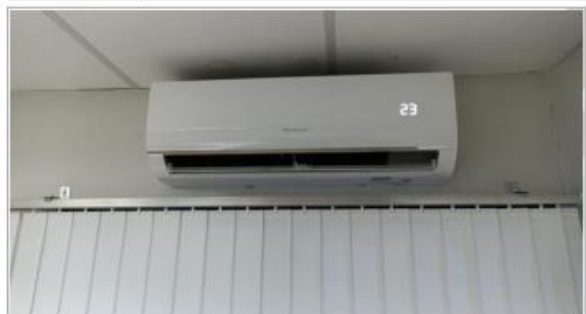
FOTO 118 - Evaporadora HW de 12K - Springer.
