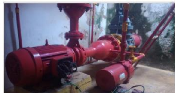
FOTO 48 - Bombas do sistema de PCI.
